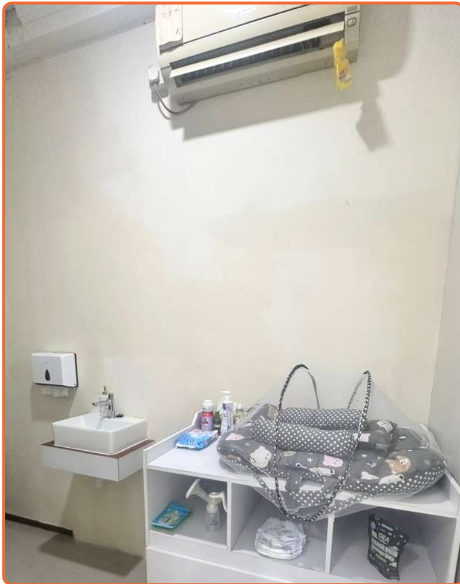
Ruang Laktasi dilengkapi dengan Air Conditioner (AC) yang nyaman
